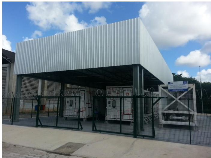
Figure 5: CDC (Centro de Dados Compartilhados) deployed at IFPE in Recife.
